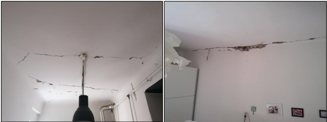
Slika B.2.13. Oštećenja stropa zadnje etaže
