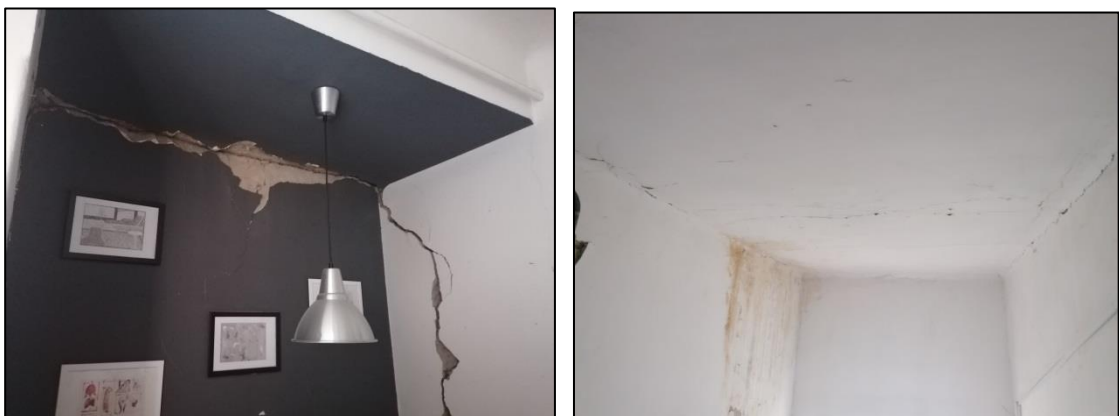
Slika B.2.15. Oštećenja na sekundarnim elementima – niše 3 kat
