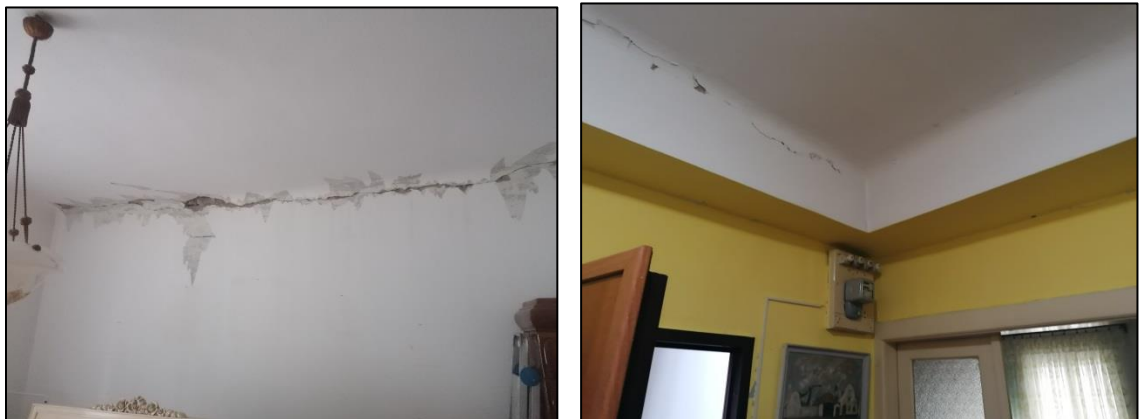
Slika B.2.14. Oštećenja stropa na spoju sa zidovima
